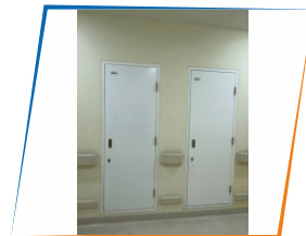
ELE & ELV SHAFT DOOR
