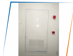
ELECTRICAL SHAFT DOOR
