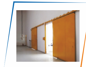
AUTO / MANUAL SLIDING FIRE DOOR
