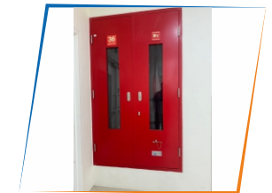
FIRE SHAFT DOOR
