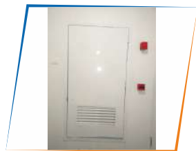
ELECTRICAL SHAFT DOOR
