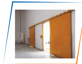
AUTO / MANUAL SLIDING FIRE DOOR
