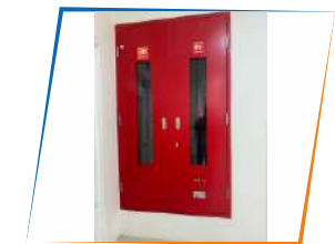
FIRE SHAFT DOOR
